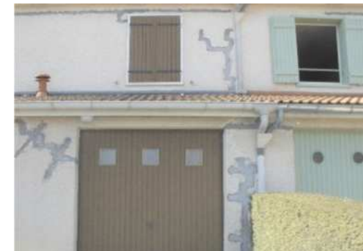
Un conséquence du retrait-gonflement des argiles : la fissuration de la structure des bâtiments
